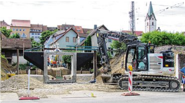
Nachdem am Wochenende unter Vollsperrung der Bahnlinie die alte Brücke aus dem Jahr 1904 abgebrochen und das Fundament für die neue Brücke vorbereitet worden war, wurde am Montagmorgen gegen 7 Uhr bereits Teil 1 der insgesamt fünf Brückenteile plus drei Seitenteile eingesetzt.
